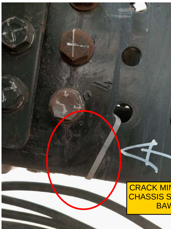
FOTO KOMPONEN YANG RUSAK
